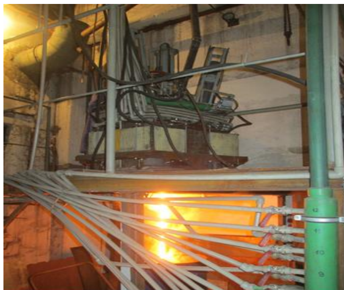
Рис. 1 – Общий вид пилотной установки с электромагнитным реактором, установленного на эстакаде
