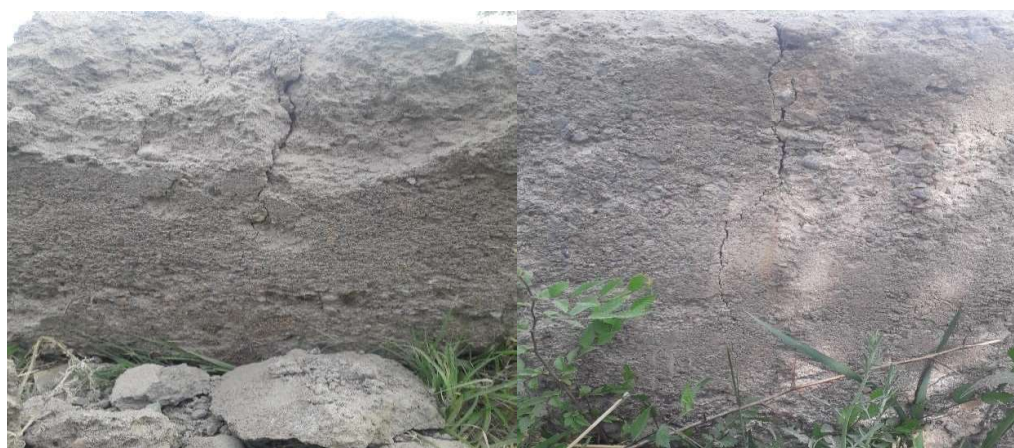
Рис. 7. Разрушение железобетонного блока составом №2.
